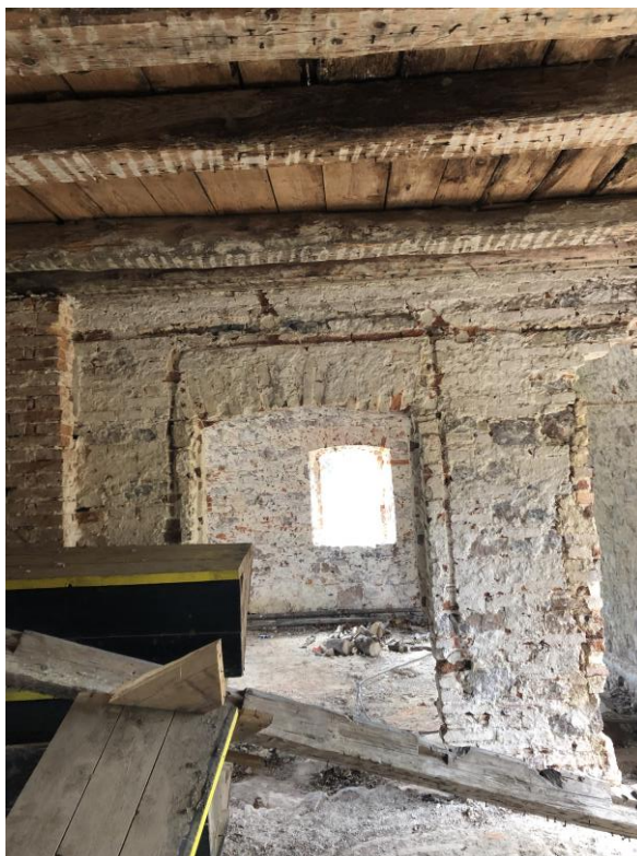
Poškodbe zaradi vodenja inštalacij
