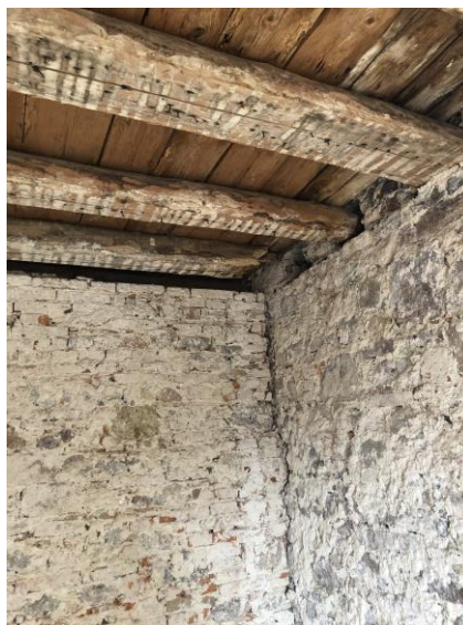
Nepovezanost veznega in obodnega zidovja
